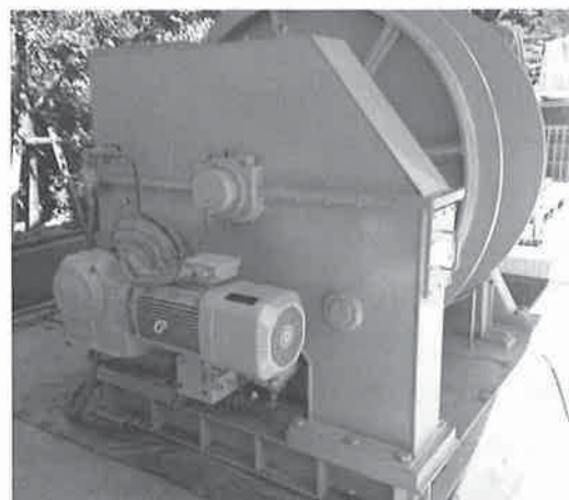
写真4 インバータ制御ウインチ
